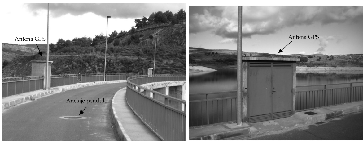
Figura 12. Casetas de coronación solidarias al cuerpo de presa de ubicación de antenas y receptores GPS.
